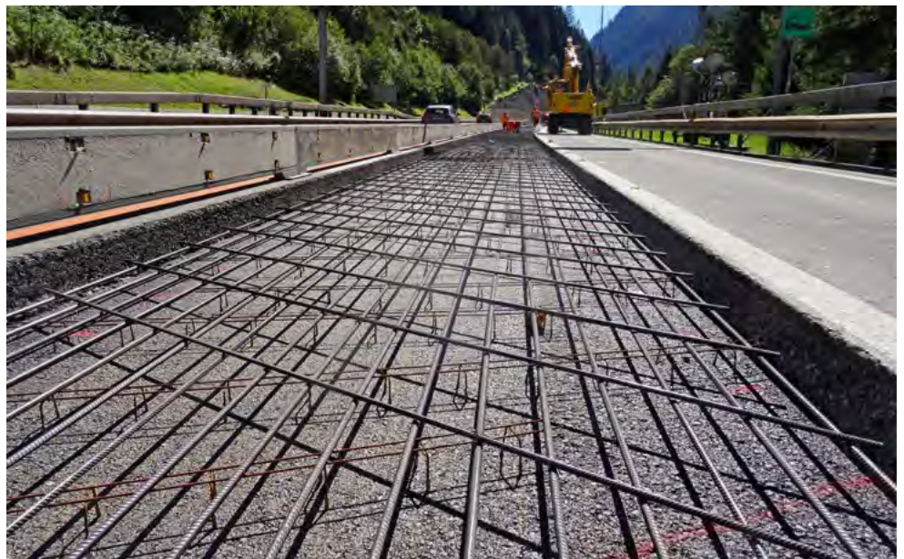
Pose de l'armature longitudinale et transversale du revêtement de chaussée sur couche de roulement en asphalte AC F 22
