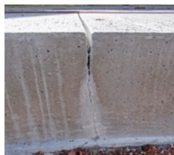
Fissure de retrait techniquement nécessaire sur le joint de dalle
