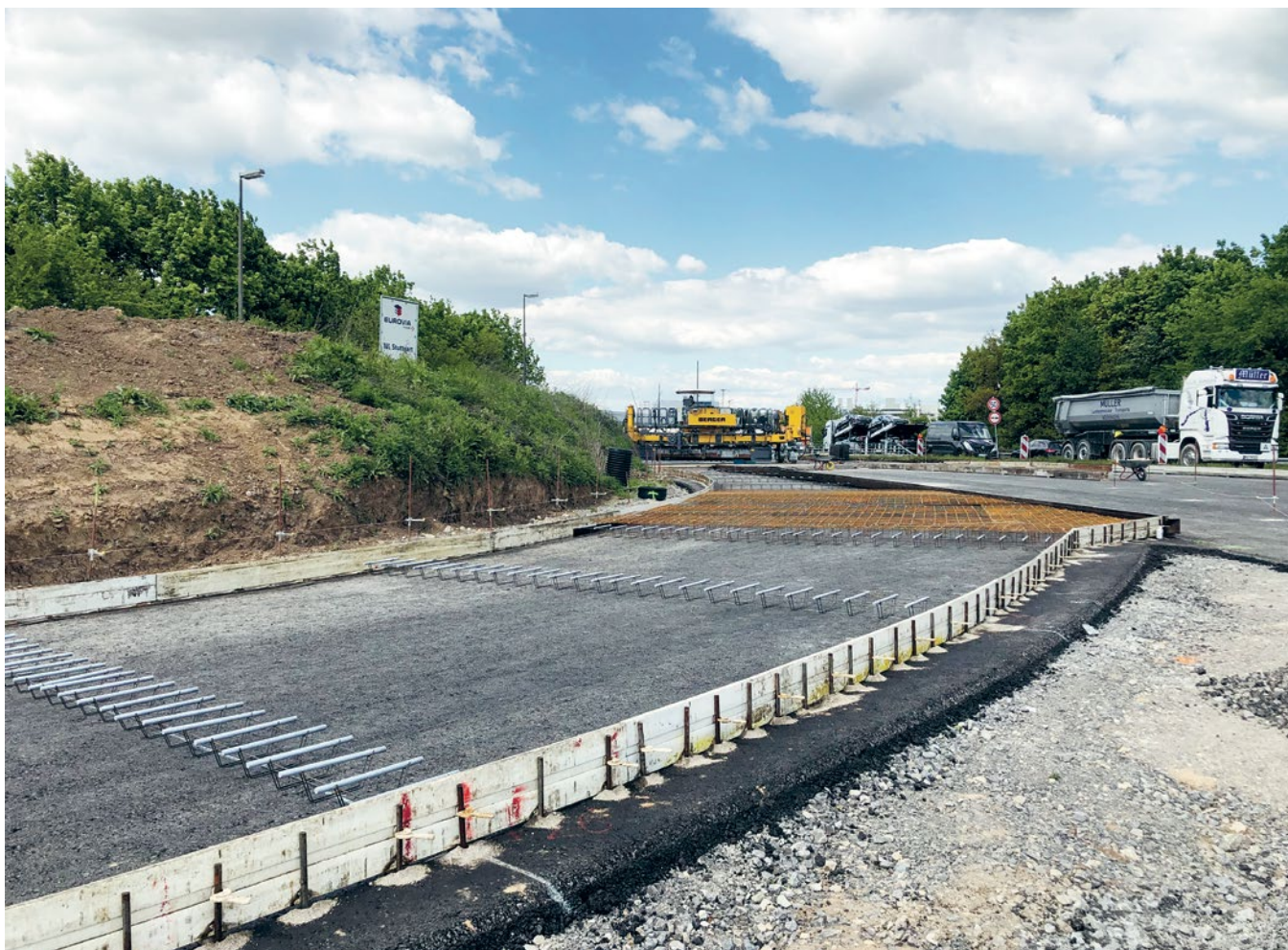
Préparation du bétonnage avec une zone d'armatures géométriquement critique. Pose des goujons dans les paniers sous le joint de retrait transversal réalisé ensuite.
