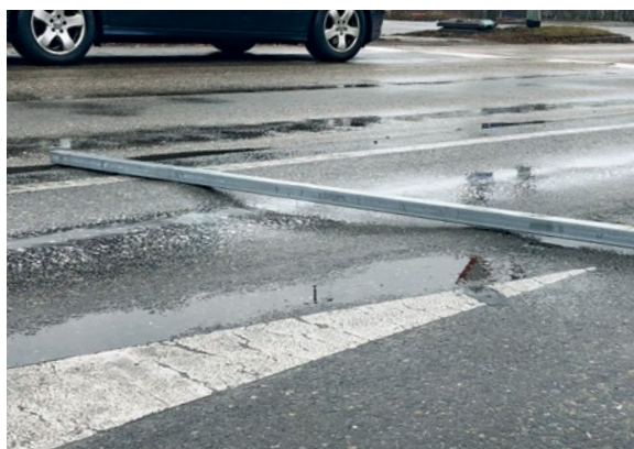
Affaissements dans l'asphalte dus à la surcharge par freinage, arrêt et reprise
