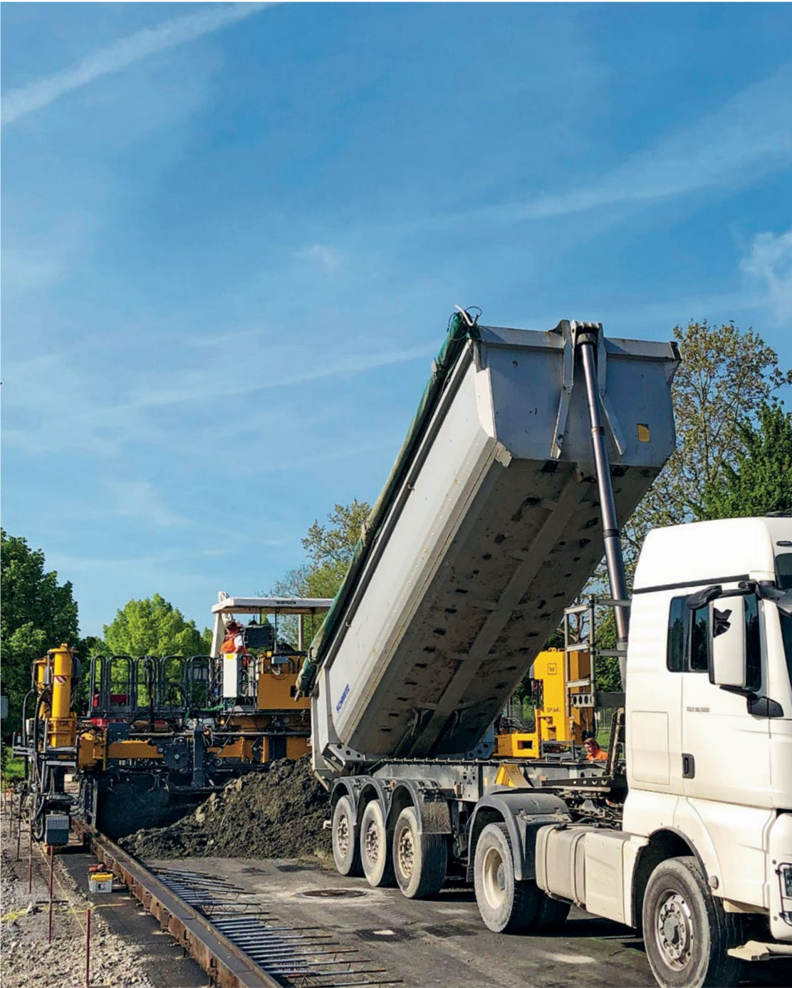
Mise en place de béton de la classe de consistance C1 avec un finisseur de route
