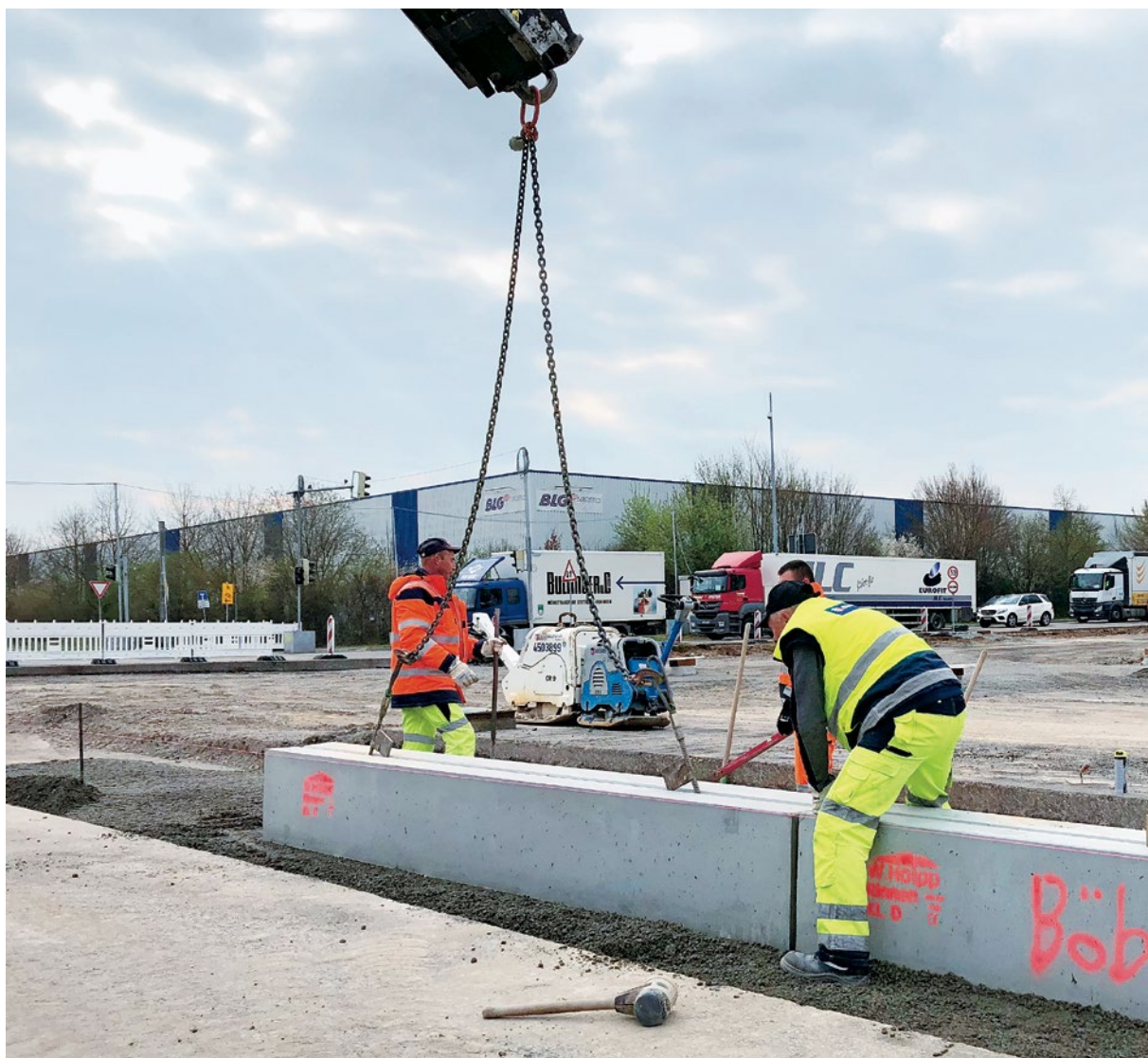
Travaux de génie civil, nouveau système d'évacuation des eaux de la chaussée plus performant
