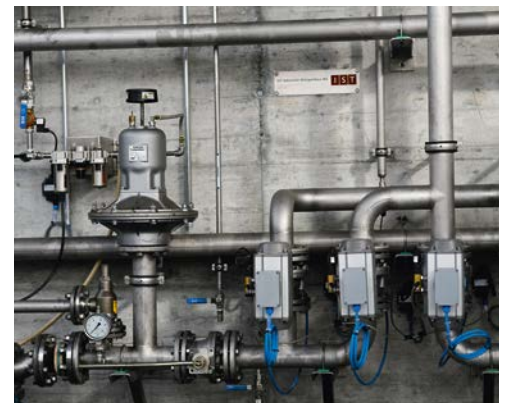
L'installation de conditionnement pour solvants répond aux normes de sécurité les plus strictes.
