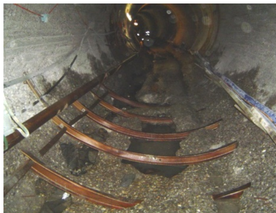
Abb. 1: Durch Hydroabrasion freigelegte Stahlträger im SBT Val d'Ambra (Foto: AET)
