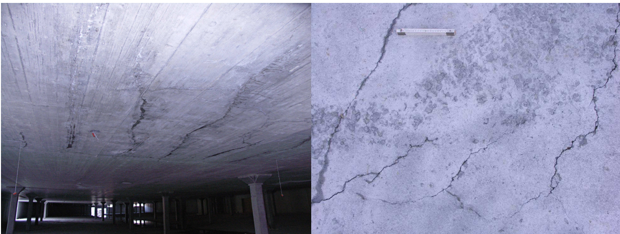
Abbildung 1: Decke (Untersicht, links, und Aufsicht, rechts) mit durchgehenden Frühschwindrissen.
